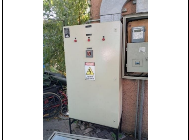
Imagen N°4: 14.02.2025 Visita de inspección a instalaciones de un nuevo empalme eléctrico del COAR ejecutadas por ENEL
