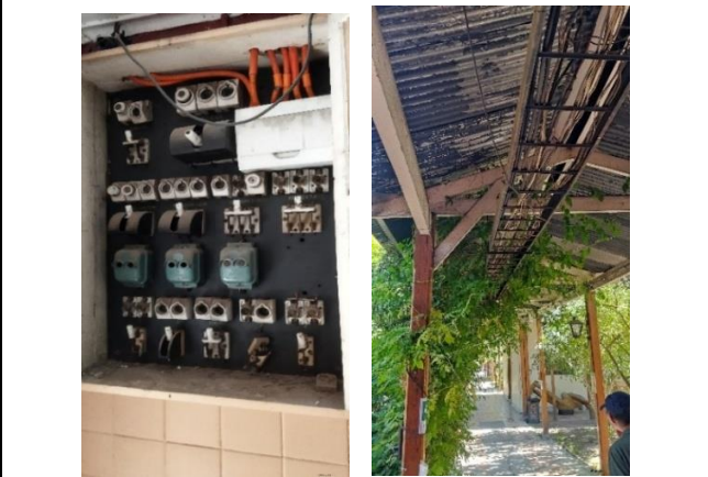
Imagen N°3: 04.02.205 visita a terreno de especialistas de la AIF, con el motivo de corroborar en terreno la factibilidad del traslado de la Subestación eléctrica que abastece al área no concesionada (área patrimonial)
