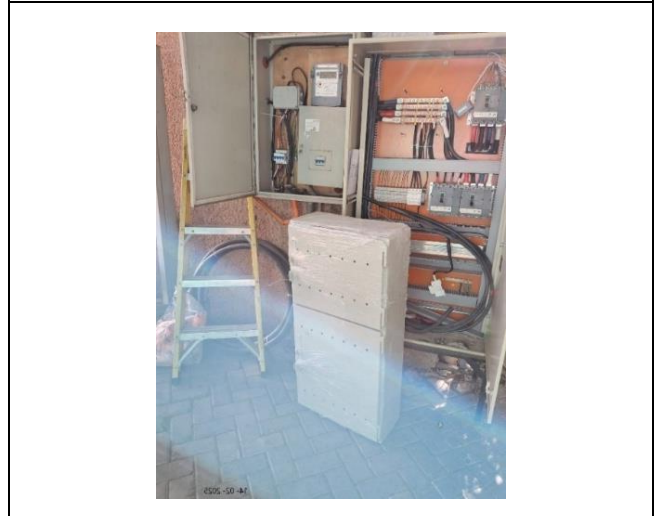
Imagen N°5: 14.02.2025 Visita de inspección a instalaciones de un nuevo empalme eléctrico del COAR ejecutadas por ENEL
