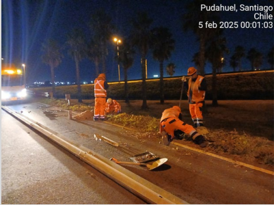
Km. 1.000 mediana limpieza de luminarias Pudahuel, Santiago Chile 4 feb 2025 16:56:57
