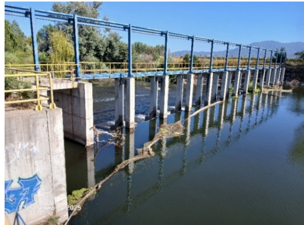
Imagen N°7. Bocatoma Uva Blanca. Vista general del Estero Chimbarongo y barreras stog-log en funcionamiento.
