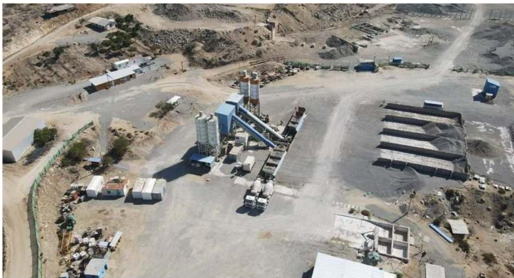
Fotografía N°7. Planta de hormigón
