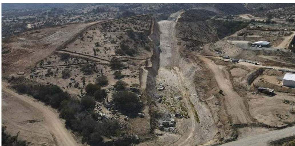
Fotografía N° 12. Evacuador de Crecidas y Rápido de Descarga.
