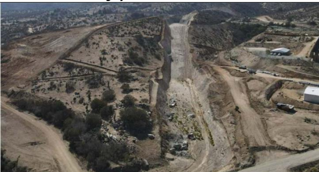
Fotografía N° 12. Evacuador de Crecidas y Rápido de Descarga.
