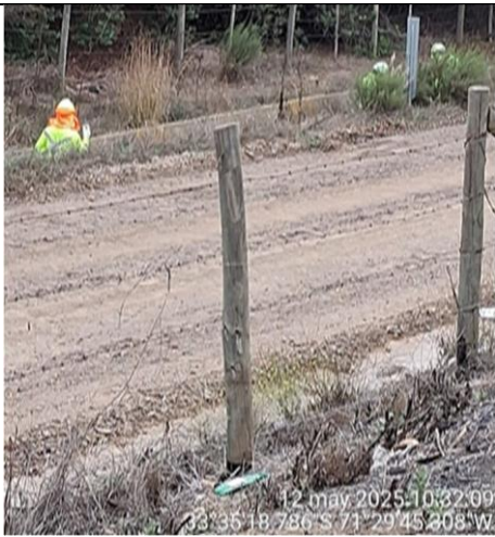
Limpieza de fosos 96+700
