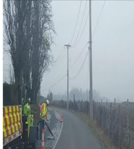
Sello en Calle de Servicio Izquierda km. 38+500
