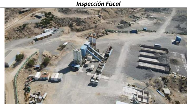
Fotografía N°7. Planta de hormigón
