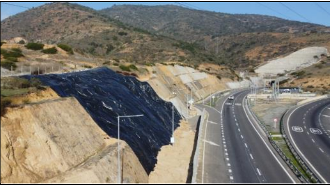
Talud Norte pendiente reparación Túnel El Melón
