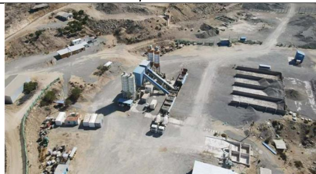
Fotografía N°7. Planta de hormigón
