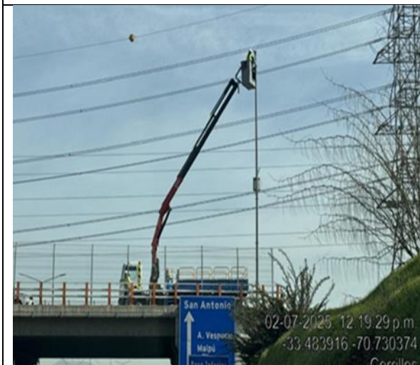
Mantenimiento de Cámaras de Vigilancia Km. 7+200- Ascendente
