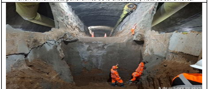
Túnel Oriente Vía Expresa de 3 Carriles (Especial salida Av. El Valle): Vista Túnel, construcción de Fases VII.
