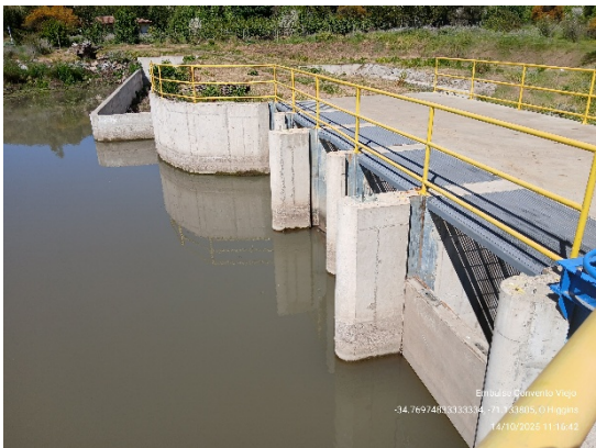
Imagen N°8. Bocatoma Canal Norte. Funcionamiento sistema de compuertas de la bocatoma.
