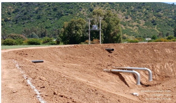
Imagen N°5. Vista general del tranque La Cabaña y cañería de succión.
