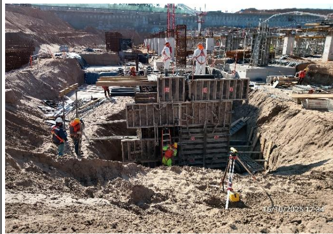
Planta Elevadora de Aguas Servidas (Sector D)
