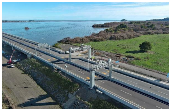
Sector A – Pórticos telepeaje – Hualpén
