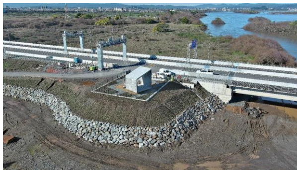
Sector A – Mirador – Hualpén
