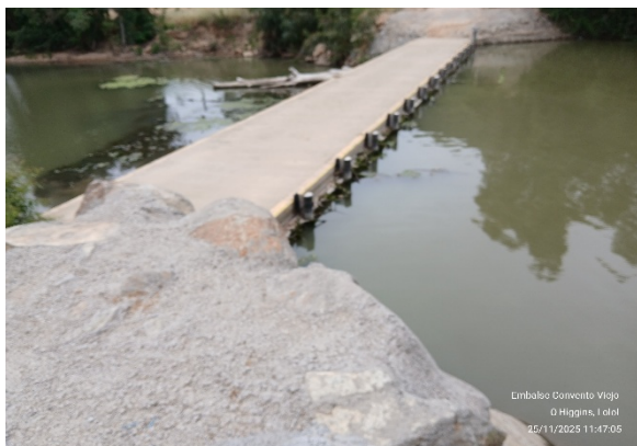
Imagen N°7. Poza Quiahue 1. Funcionamiento sistema de compuertas en la poza.
