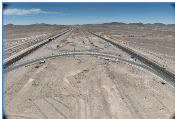
Paso de Emergencia Dm 31,000
