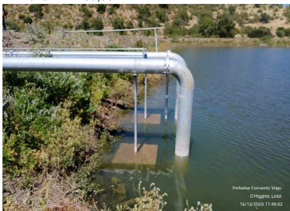
Imagen N°5. Vista general preparación sala de bombas del tranque La Cabaña, tuberías HDPE y válvula de cierre.
