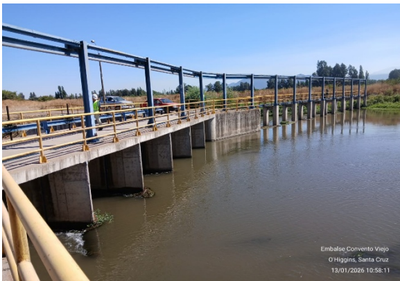
Imagen N°7. Bocatoma Las Toscas.
