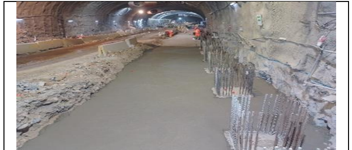
Frente 7, Túnel Híbrido: Se avanza en confección de emplantados para losas en secciones A, B y C, por costados oriente y poniente
