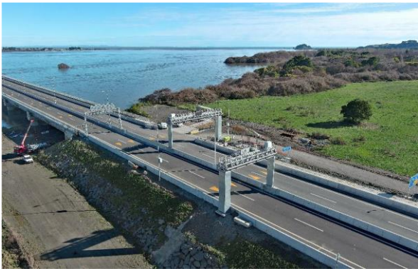
Sector A – Pórticos telepeaje – Hualpén
