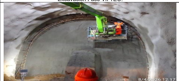
Túnel Minero Ramal Blest Gana.
