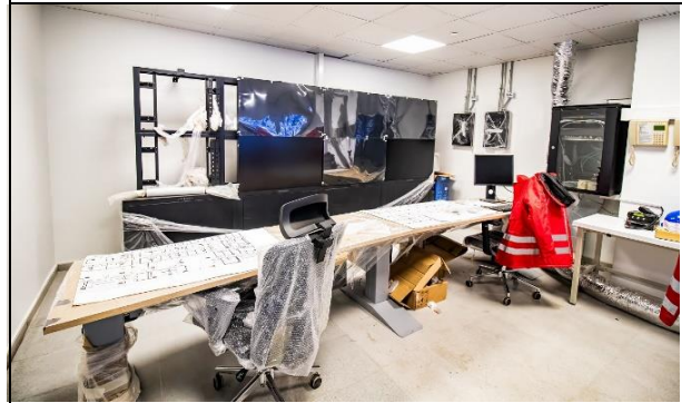
Sala de control
