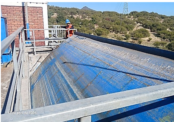
Imagen N°3. Presa Auxiliar. Prueba Operacional de la compuerta N° 1 realizada sin inconvenientes, alcanzando una apertura de 3,5 metros aproximados.
