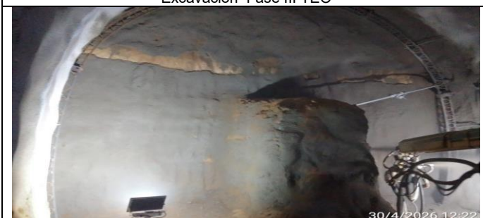
Túnel Minero Ramal Blest Gana
