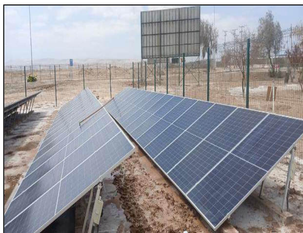
SC ejecuta limpieza de modulos fotovoltaicos
