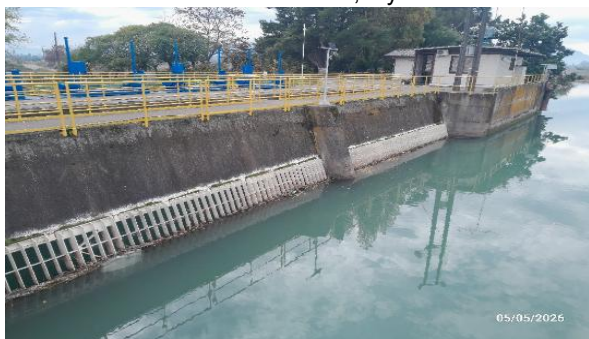
Imagen N°2. Bocatoma río Teno, rejas de captación del canal Teno-Chimbarongo.
