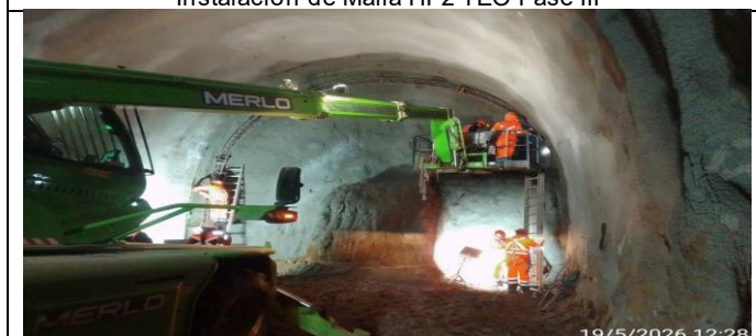
Túnel Minero Ramal Blest Gana
