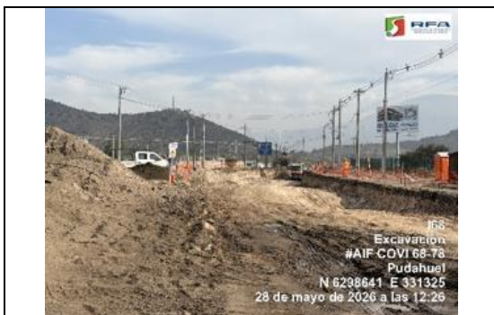
Paso Soterrado R68
