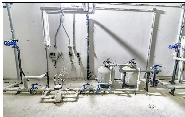
Tratamiento de agua de Piletas Ornamentales
