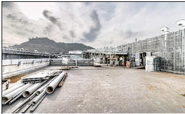
Piso Técnico HDS
