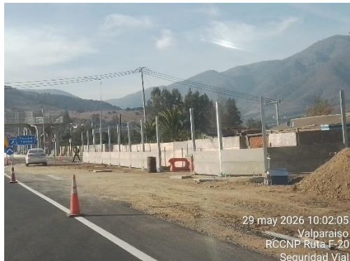
Sector 1-Pucalán Dm 16.500 Instalacion Pantallas Acústicas, margen izquierdo
