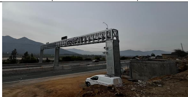
Pórtico instalado con su equipamiento correspondiente a la Plaza de Peaje Las Vegas ( Sub-Sector E )
