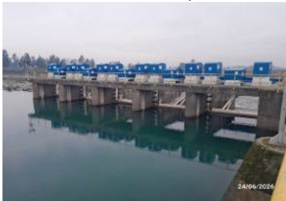
Imagen 2. Operaciones Poza de la Bocatoma Teno. Cota de operación: 308,50 m.s.n.m. Caudal de entrega al Río Teno: 4,0 m 3 /s (compuerta N°3 con apertura de 0,10m).
