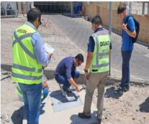
Cámara sellas recorrido de fibra por landside
