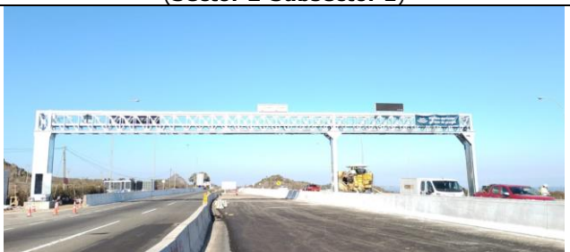
Pórtico de Cobro Instalado Plaza de Peaje Pichidangui (Sector 2-Sub-Sector F)
