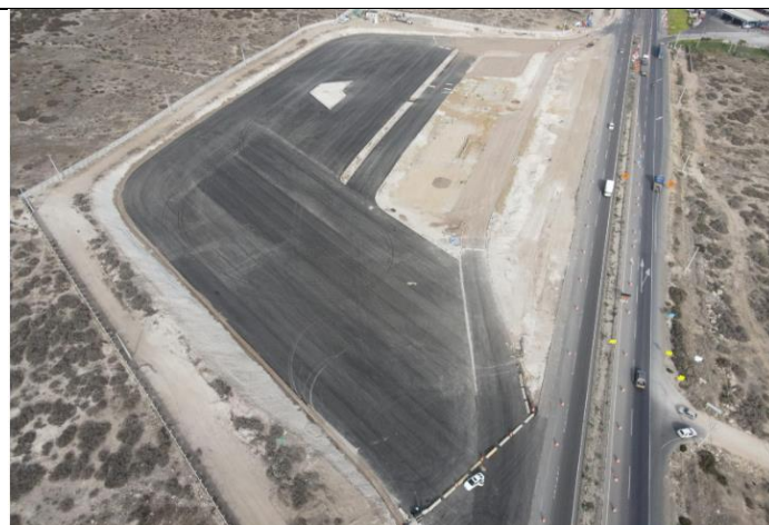
Área Servicios Generales ASG –08 – Km. 455.000.
