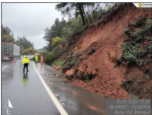
Imagen N°3. Remoción de talud por caída de árbol. Ruta 152 Ránquil, Km 35.600
